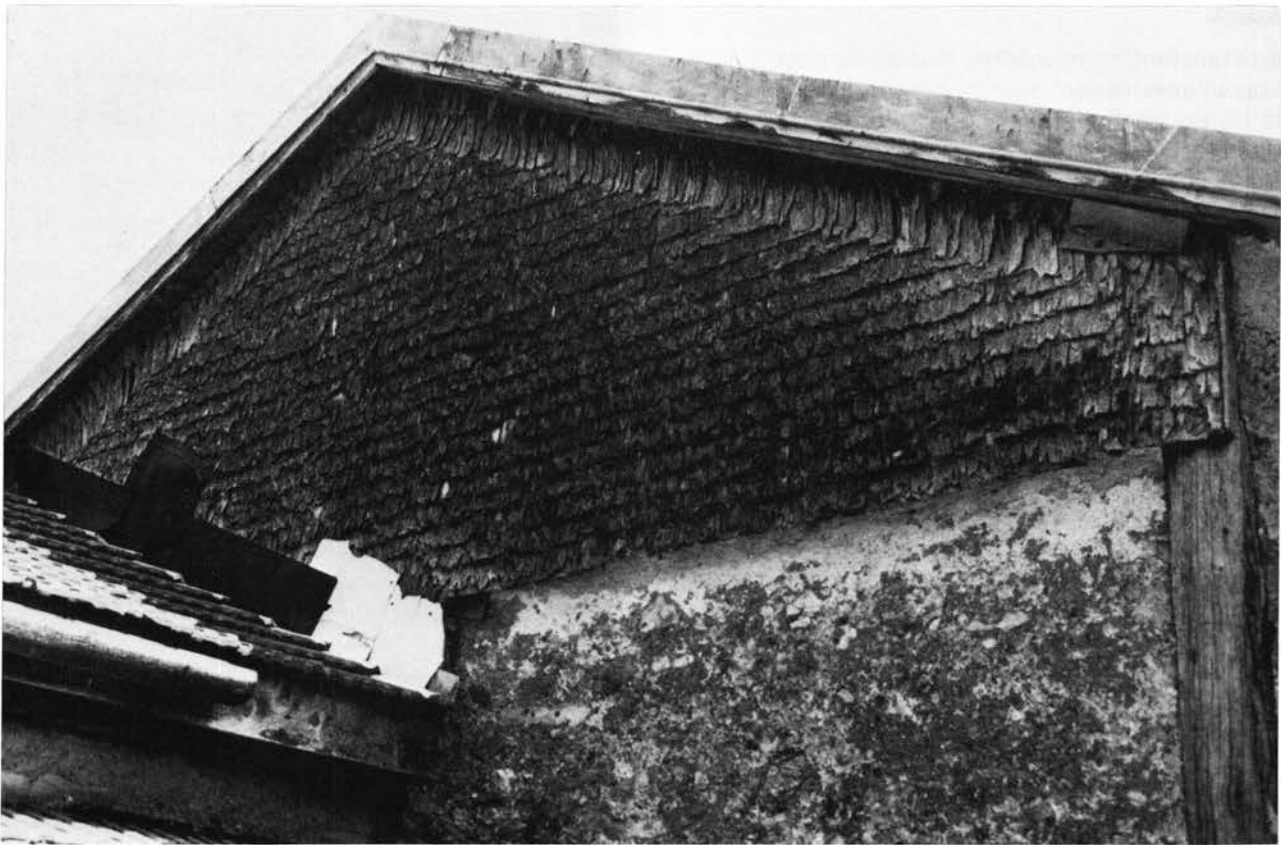
Fig. 31 Bullet, ancienne chape en tavillons, raccord droit sous l'avant-toit.
